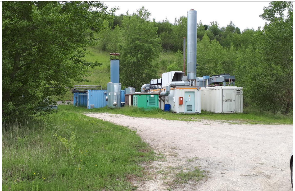
Bild 16: Verdichter-Fackelanlage am Böschungsfuß der Altdeponie zur Verbrennung von Deponiegas. 28.05.2019
